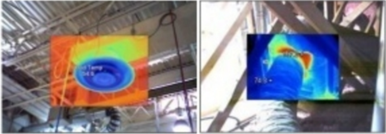
Рис. 6: Два изображения показывают использование тепловидения для проверки работы и балансировки систем вентиляции или систем HVAC, а также контроля утечек/изоляции воздушных каналов (температуры указаны по шкале Фаренгейта).
